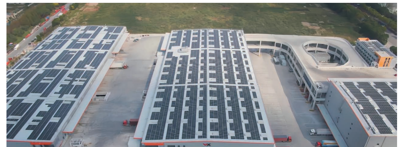
万纬上海奉贤临港园区光伏分布式电站
